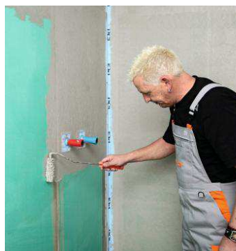
3. Нанесите первый слой PCI® Lastogum (серый) на прогрунтованную поверхность с заходом на ленту
