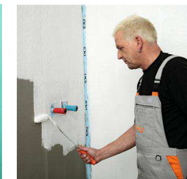
5. После высыхания примерно через час нанесите второе защитное покрытие PCI® Lastogum (белый). Первое покрытие PCI® Lastogum (серый) не должно просвечивать, иначе может потребоваться еще один слой.
